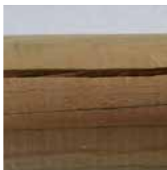
Cracks/Grietas/Fente/Risse/ Crepe/ Barsten/Fendas
