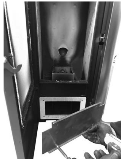
Fig. 31 - Den Inspektionsstopfen entfernen
