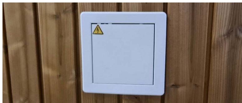
Abbildung 3: Darstellung des am Hot Tub angebrachten Warnhinweises für Gefahr durch einen tödlichen Stromschlag
