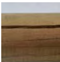
Cracks/Grietas/Fente/Risse/ Crepe/ Barsten/Fendas
