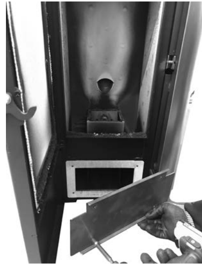
Fig. 31 - Den Inspektionsstopfen entfernen
